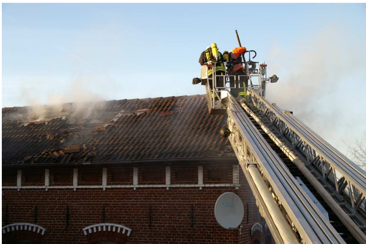
Bild 14: 17:58 Uhr – Nachdem die Dachhaut geöffnet und Glutnester abgelöscht wurden, nahm die Rauchentwicklung deutlich ab. Letzte Nachlöscharbeiten wurden im Innenangriff durchgeführt.
